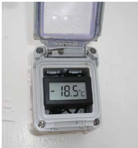
Foto 2: particolare del display di rilevazione visiva della temperatura interna
